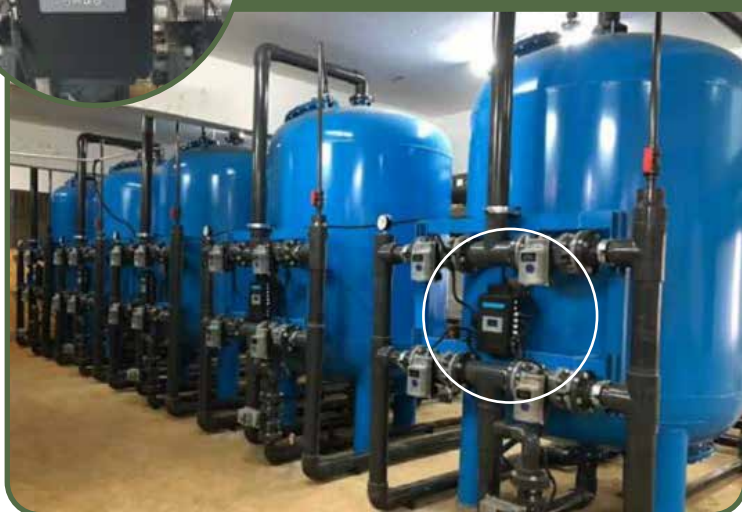
BATERÍA DE VÁLVULAS
