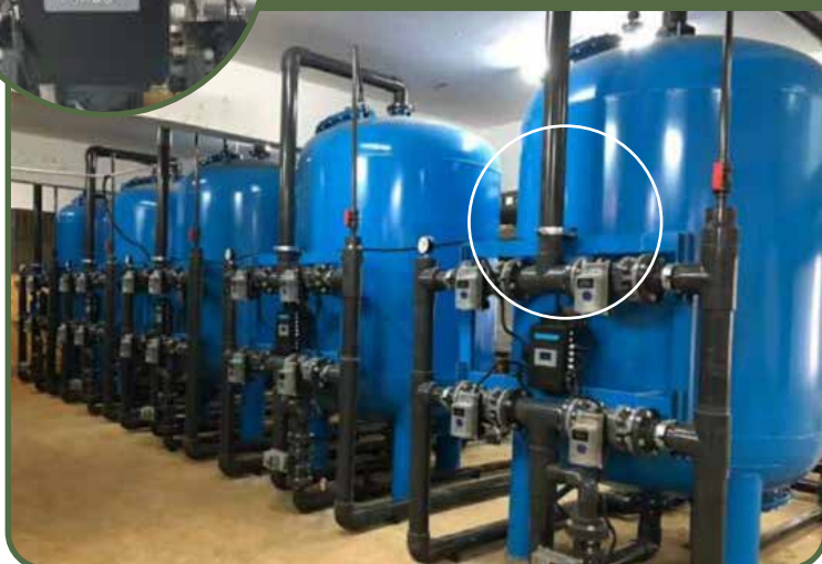
BATERÍA DE VÁLVULAS
