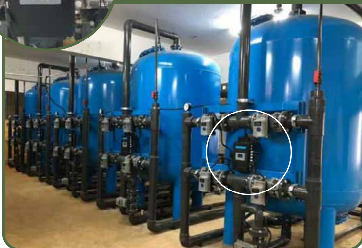
BATERÍA DE VÁLVULAS
