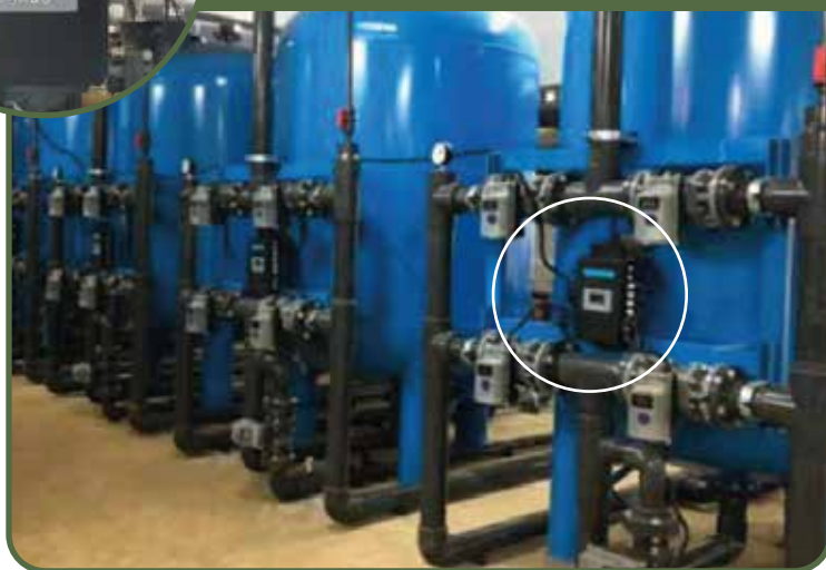
BATERÍA DE VÁLVULAS
